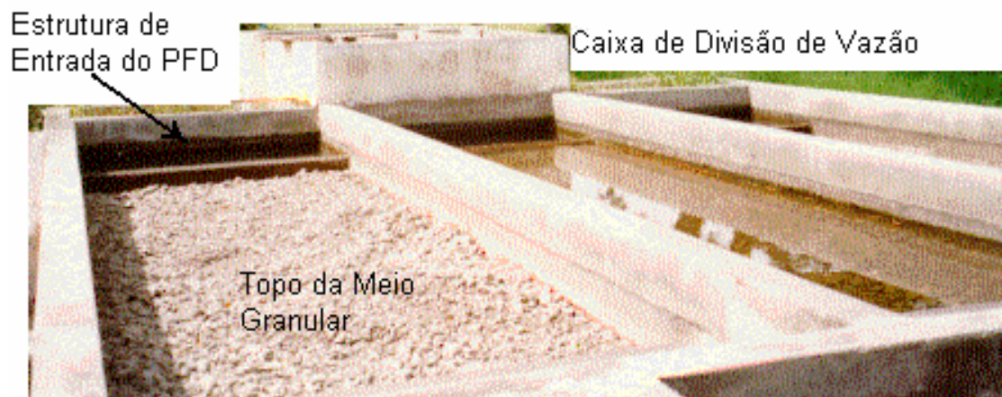
Figura 4.27 – Foto de uma instalação com três unidades de pré-filtração dinâmica
