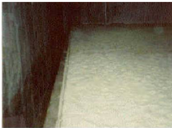
Figura 4.10 – Foto ilustrando o canal de descarga (e de entrada) de um filtro lento operado com nível de água variável
